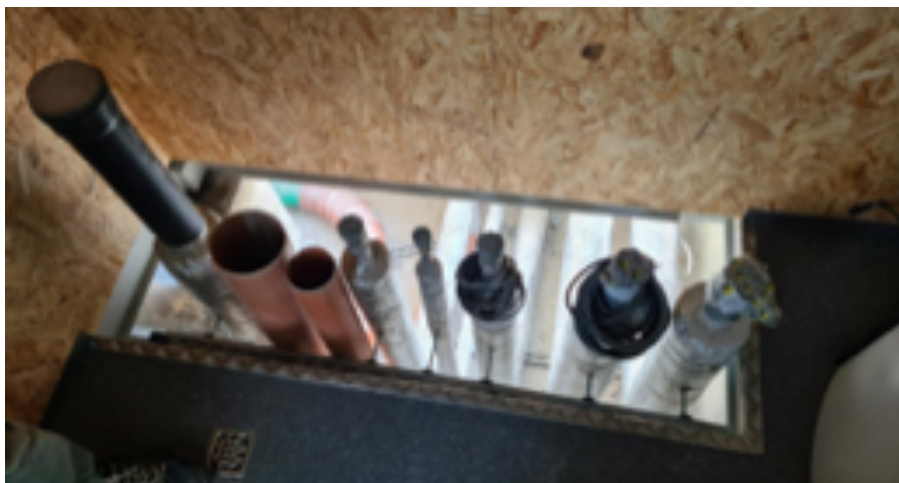
Connexions hydrauliques et électriques depuis le bâtiment
