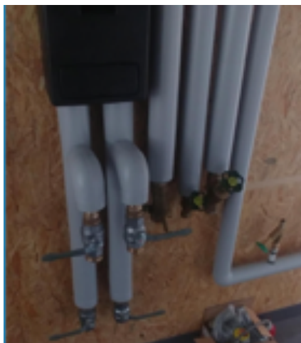
Connexion hydraulique du Daikin Energy Modul
